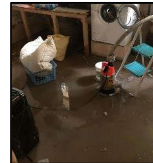
Abbildung 7: Überflutete Kellerabteile © Feuerwehr Weitramsdorf (2021)
